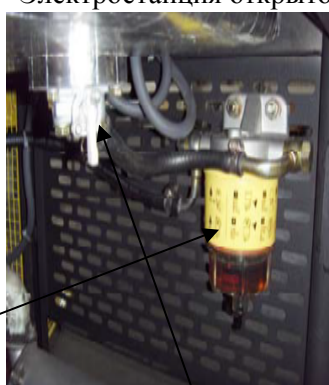
Электростанция открытого типа
